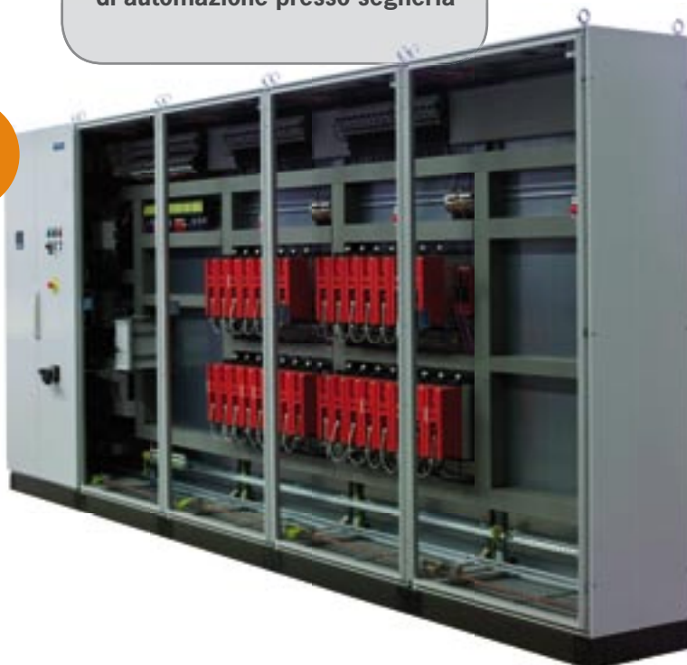
Quadro di comando e controllo di automazione presso segheria
