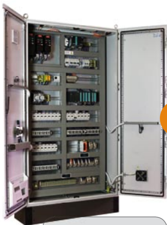
Quadro di comando per la gestione dell'impianto di un magazzino automatico
