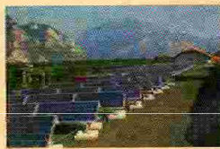
Impianto Tramontin 20 kWp realizzato da Eusun nel 2009 a Lavis (Tn)
